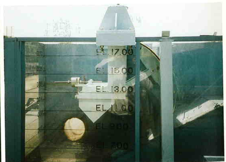
下流水位調節水門 (HLAG-400)
