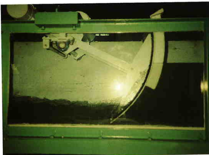
上流水位調節水門 (HUAG-400)
